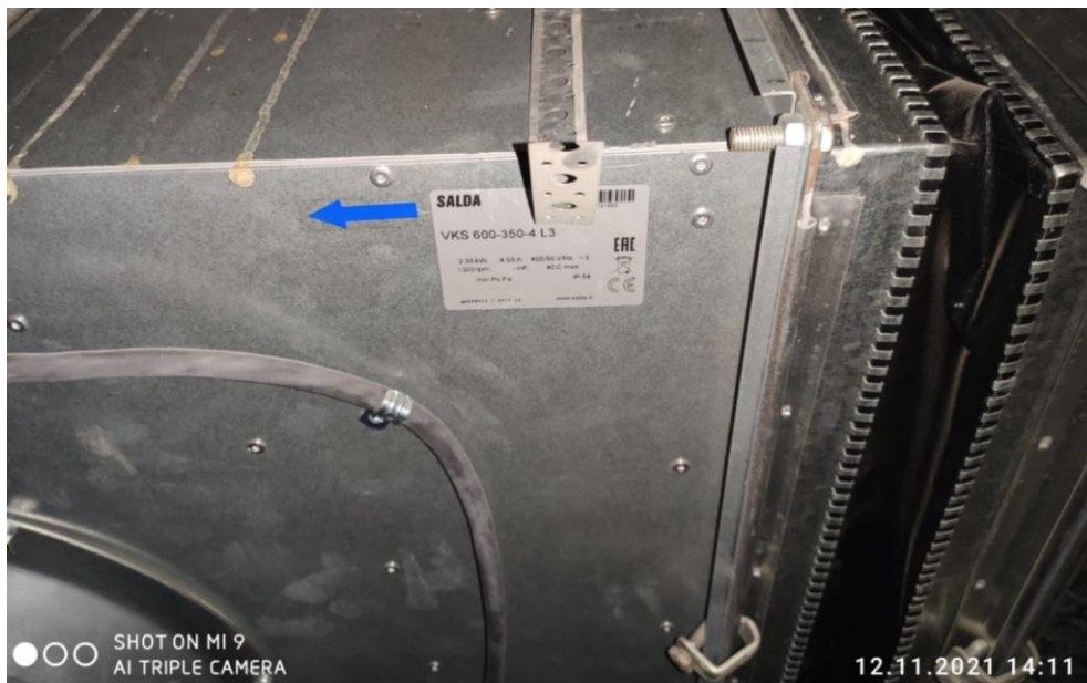
Фото 26 – Вид марки вентиляционной установки В27
