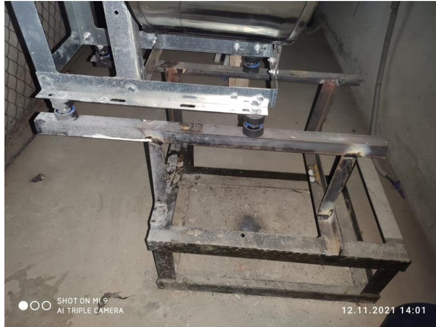
Фото 22 - Смонтированная вентиляционная система В25.2. Отсутствует антикоррозионное покрытие металлических поверхностей станины
