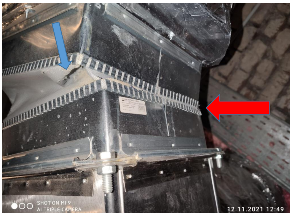
Фото 5 - Смонтированная вентиляционная установка Вн 2. Гибкая вставка смонтирована в недопустимом положении. Имеется разрыв гибкой вставки из-за неправильного монтажа (указано синей стрелкой).
