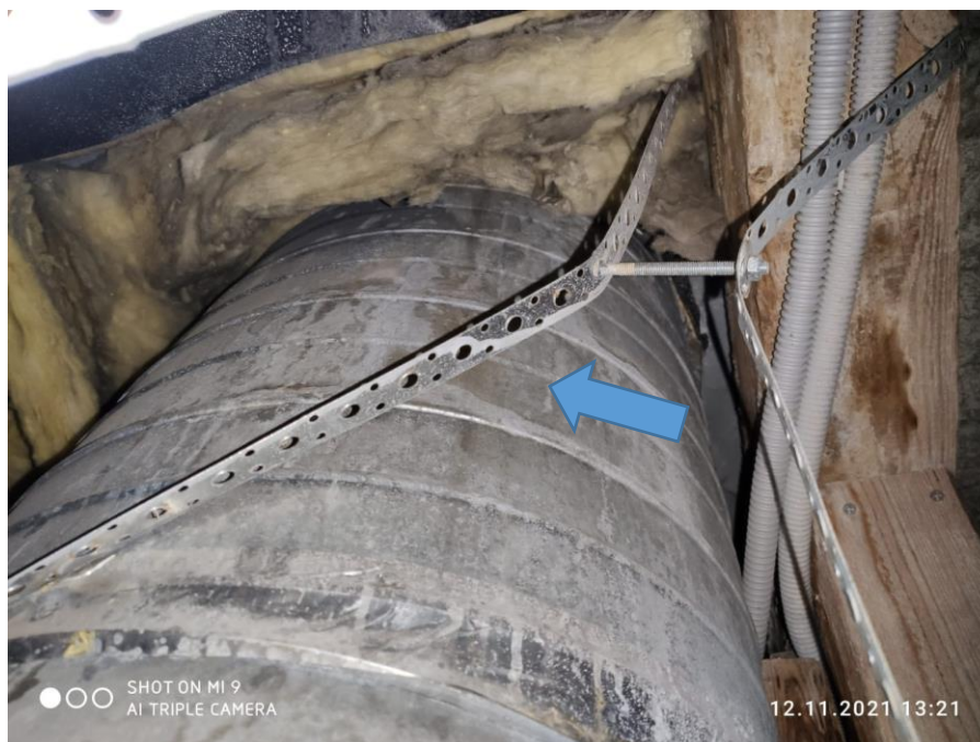
Фото 7 - Смонтированная вентиляционная система Вн 2. Отсутствует огнезащитное покрытие на воздуховоде. Не выполнена заделка узлов прохода через кровельное пространство
