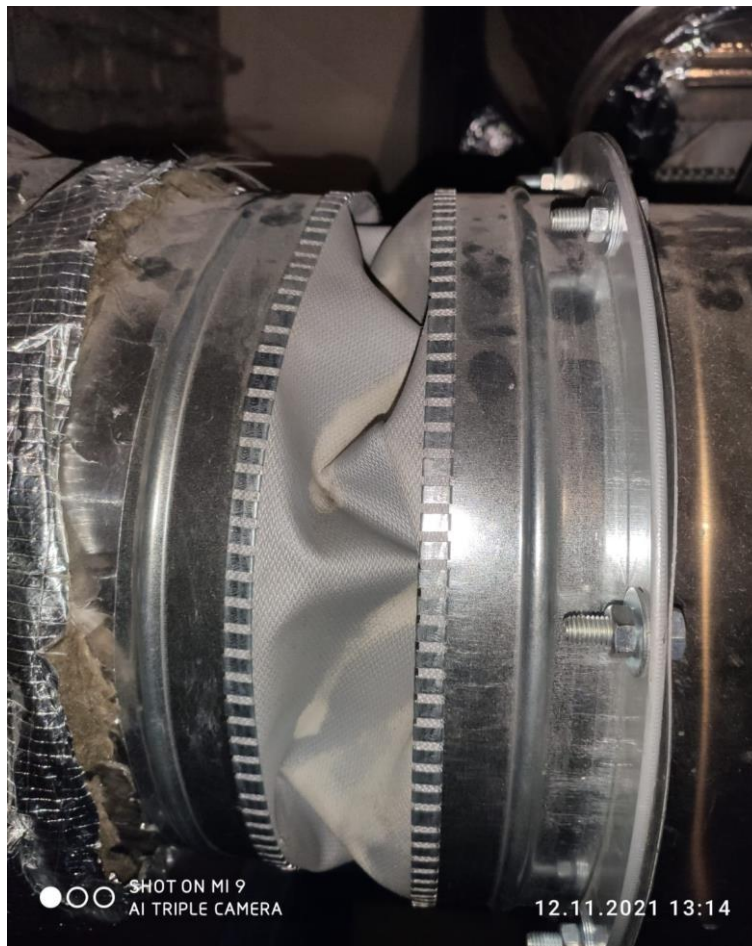
Фото 6 - Смонтированная вентиляционная установка Вн 2. Гибкая вставка на всасе вентилятора, смонтирована в недопустимом положении, слишком зажата и имеет перекус по оси
