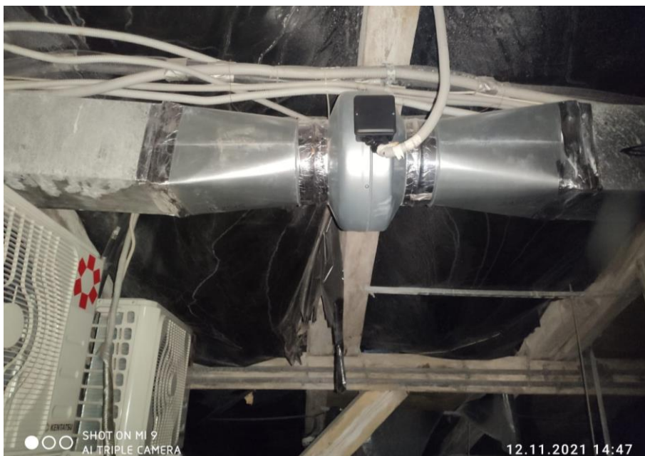
Фото 30 – Отсутствие маркировки на вентиляционной установке В24
