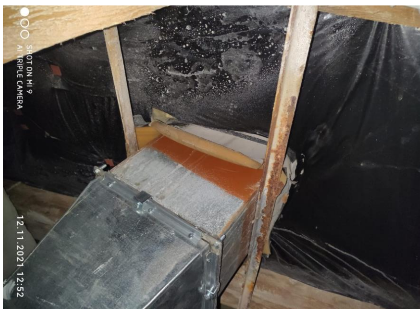
Фото 21 - Смонтированная вентиляционная система В25.2. Отсутствует огнезащитное покрытие на воздуховоде. Не выполнена заделка узлов прохода через кровельное пространство
