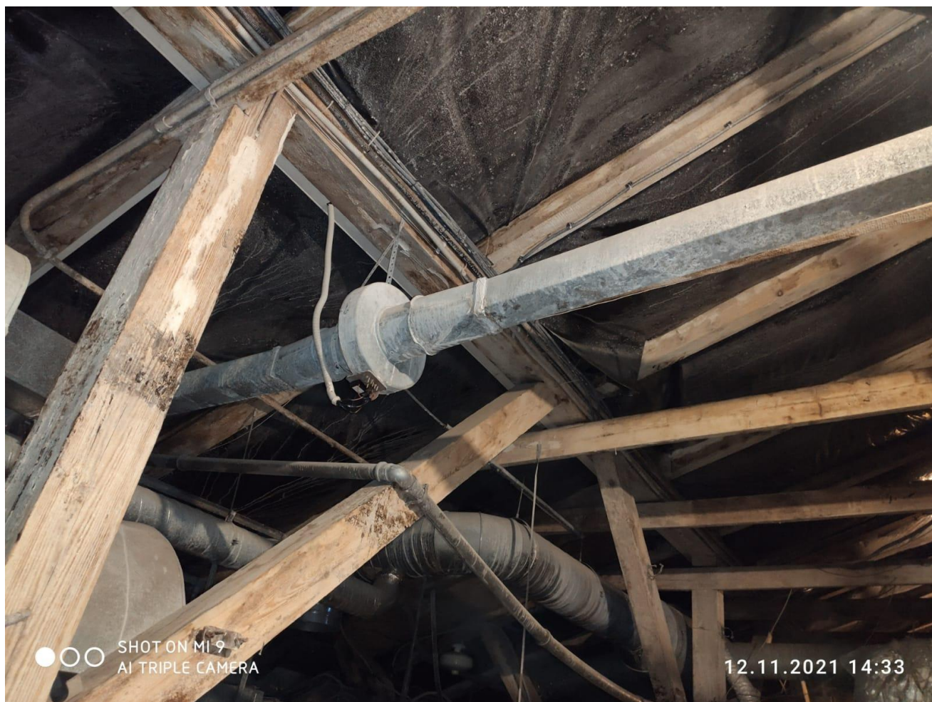
Фото 29 - Вид вентиляционная установка В28
