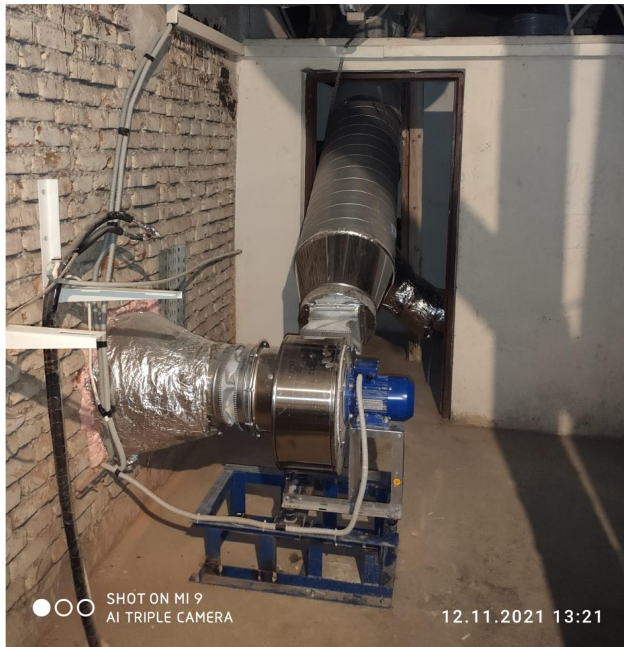
Фото 1 - Общий вид вентиляционной системы Вн 2 в зоне венткамеры
