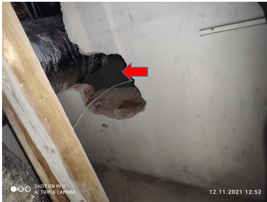
Фото 14 - Смонтированная вентиляционная система В 29. Узел прохода через стену не заделан должным образом
