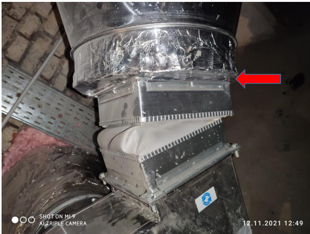
Фото 4 - Смонтированная вентиляционная установка Вн 2. Переход с сечения 220x220 на сечение диаметром 315 мм выполнен не из унифицированных деталей (недопустимое заужение проходного сечения). Гибкая вставка смонтирована в недопустимом положении
