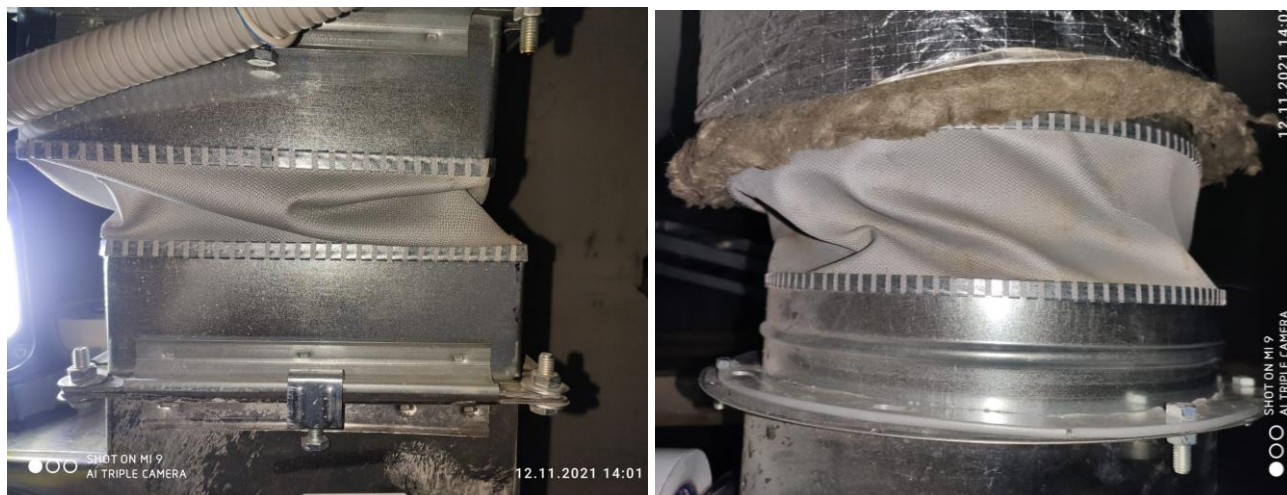
Фото 19 и 20 - Смонтированная вентиляционная установка В25.2. Гибкие вставки смонтированы в недопустимом положении
