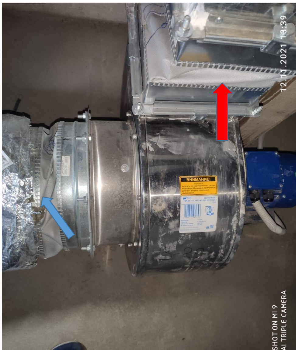
Фото 13 - Смонтированная вентиляционная установка В29. Гибкие вставки смонтированы в недопустимом положении
