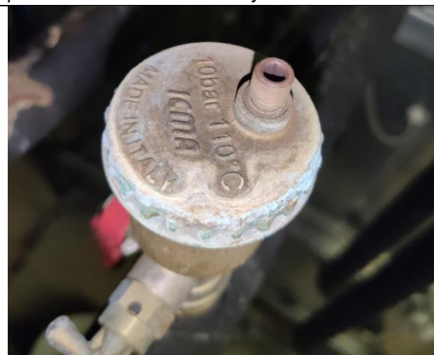
Фото 3 - Нарушена герметичность в результате деформации пластиковых и резиновых элементов воздухоотводчика
