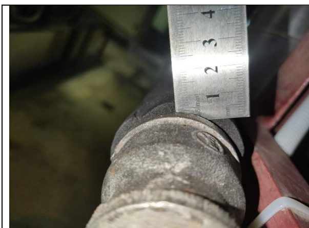
Фото 5 - Толщина тепловой изоляции составляет 9 мм, что не соответствует проектным решениям
