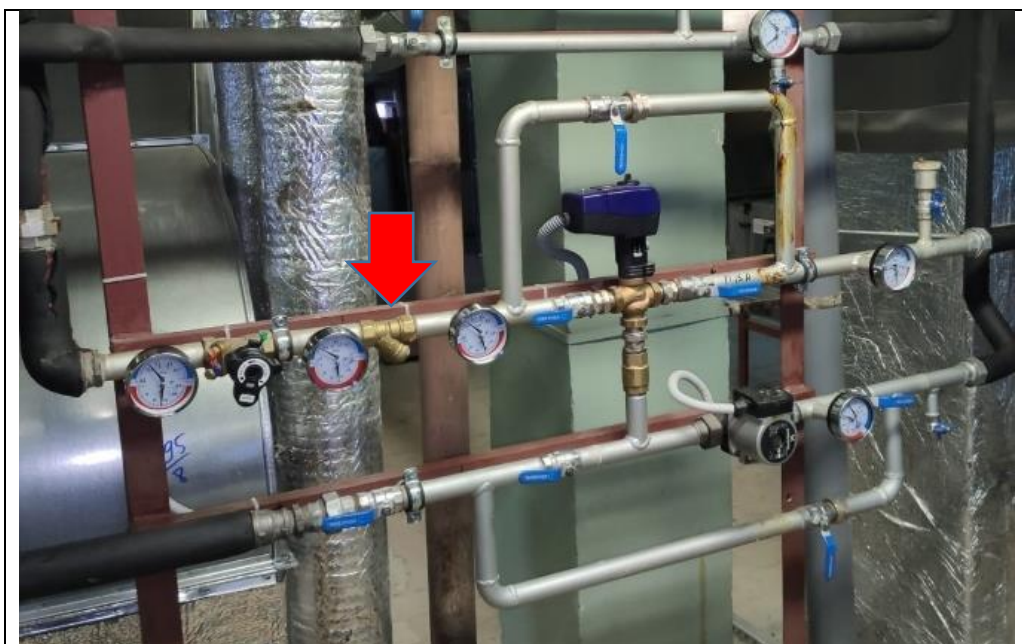
Фото 24 – На смесительном узле вентустановки П15 на подающем трубопроводе установлен грязевой фильтр, улавливающий все механические частицы, которые бы могли оказать негативное влияние на работу смесительного узла.
