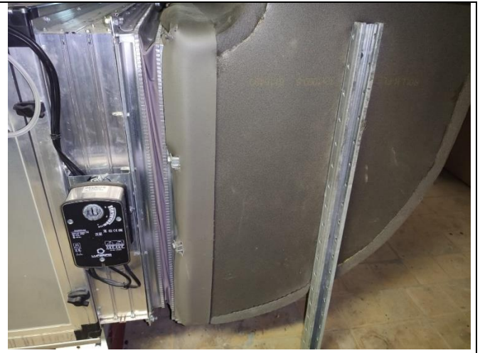
Фото 12 - Имеется перекося гибкой вставки на вентиляционной установке П15а, что в последующем приведет к ее разрыву
