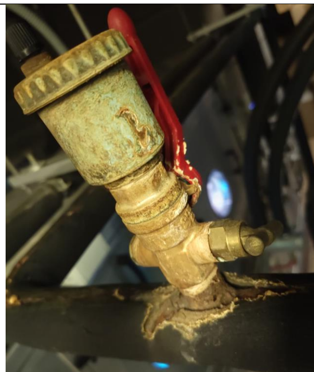
Фото 1 - Нарушена герметичность в результате деформации пластиковых и резиновых элементов воздухоотводчика
