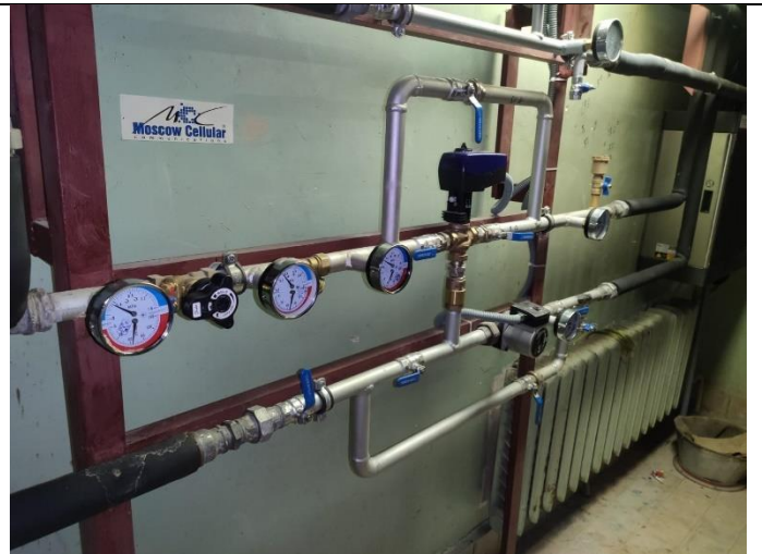
Фото 10 - Смесительные узлы первой и второй ступени подогрева вентустановки П15а не теплоизолированы
