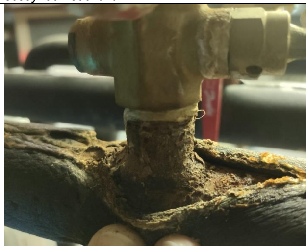
Фото 4 - Коррозионные процессы на поверхности стальной трубы в результате протекания воды из воздухоотводчика
