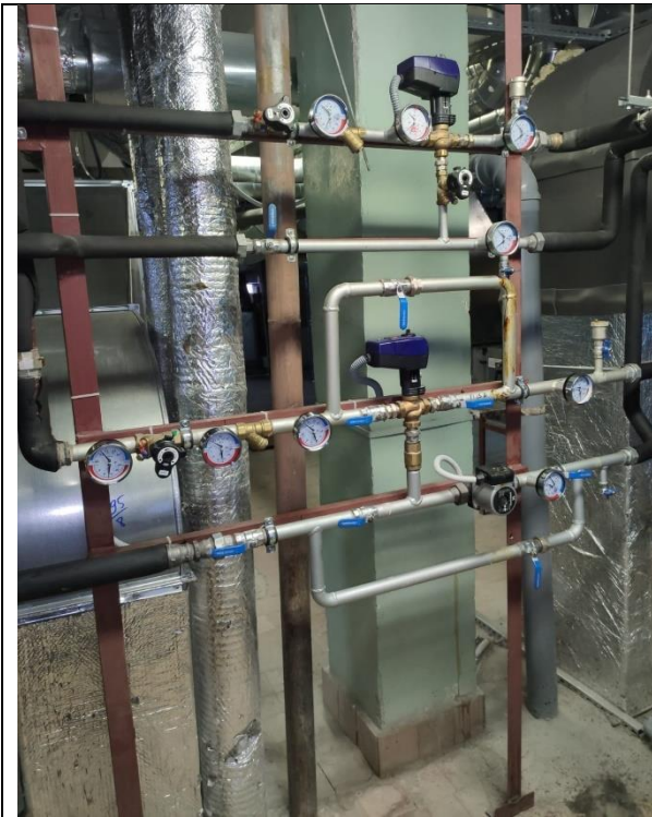
Фото 9 - Смесительные узлы первой и второй ступени подогрева вентустановки П15 не теплоизолированы
