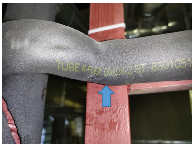
Фото 7 - Заводская маркировка на тепловой изоляции свидетельствует, что толщина теплоизоляционной трубки оставляет 9 мм, что не соответствует проектным решениям
