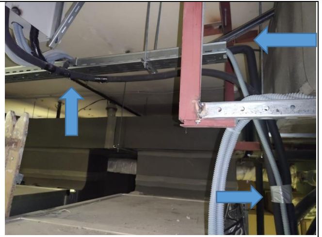
Фото 16. Трубопроводы холодоснабжения не закреплены должным образом и проложены в электрических лотках
