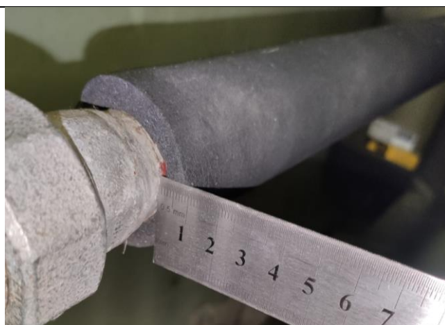
Фото 6 - Толщина тепловой изоляции составляет 9 мм, что не соответствует проектным решениям
