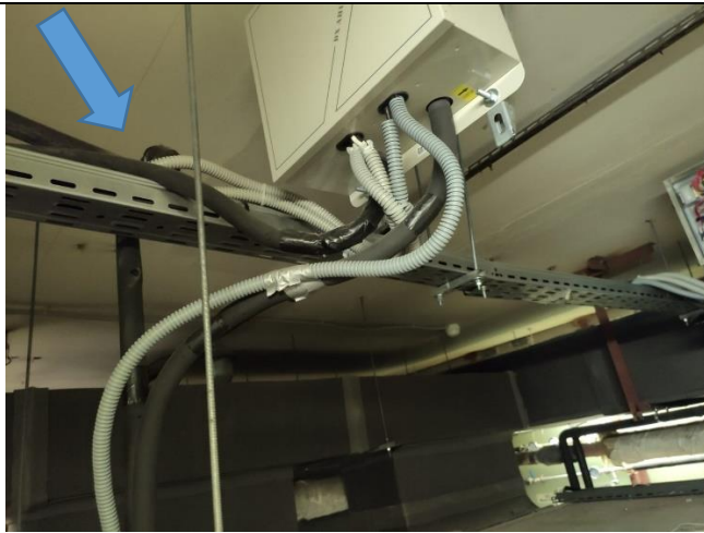
Фото 15. Трубопроводы холодоснабжения не закреплены должным образом и проложены в электрических лотках
